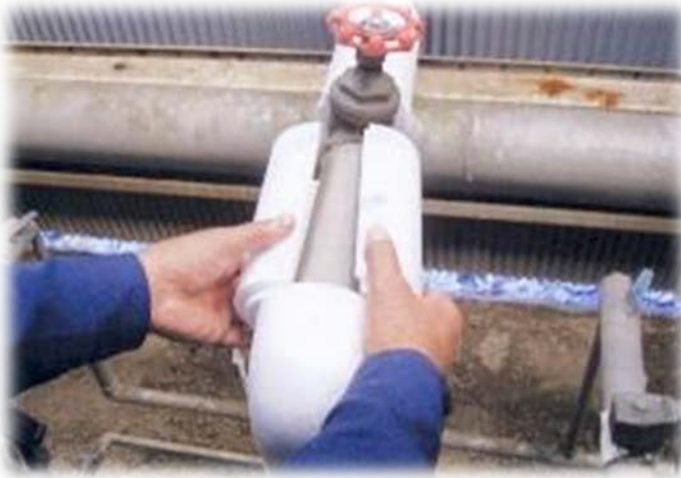
配管断熱 (パイプカバー)
