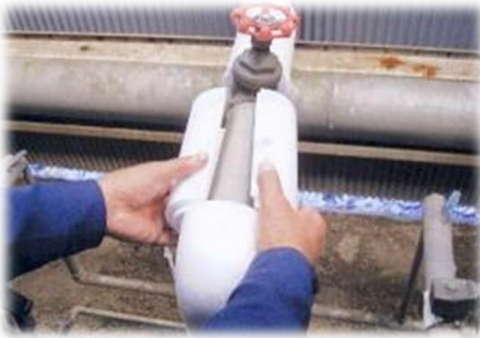
配管断熱 (パイプカバー)
