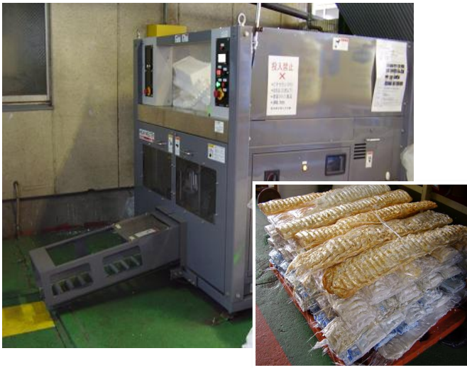
(写真 17) 減容化設備とインゴット
